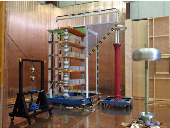
写真1 更新した雷インパルス電圧課電装置外観（弊所高電圧試験室）
