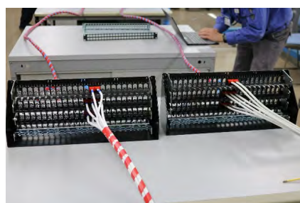
写真2 パッチパネルでの接続
